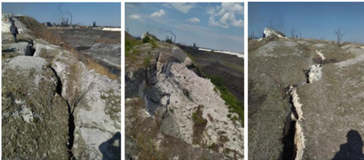
Рисунок 1. Прояви небезпечних інженерно-геологічних явищ – обвали, зсуви та розтріскування потужного шару фосфогіпсу на північній дамбі хвостосховища «Дніпровське»
